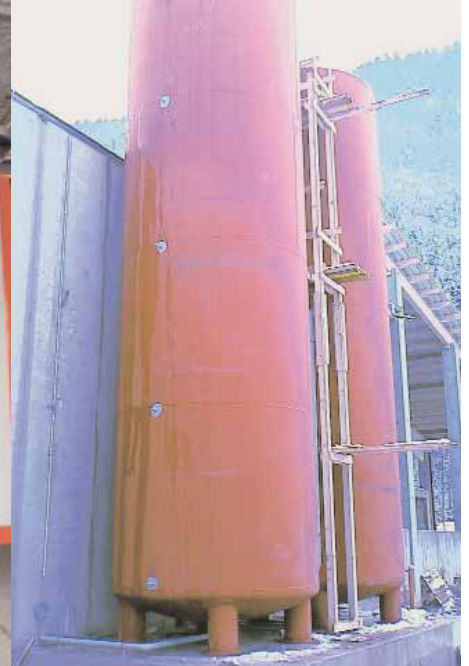
Angerer-Pufferspeicher für die Speicherung des Warmwassers
