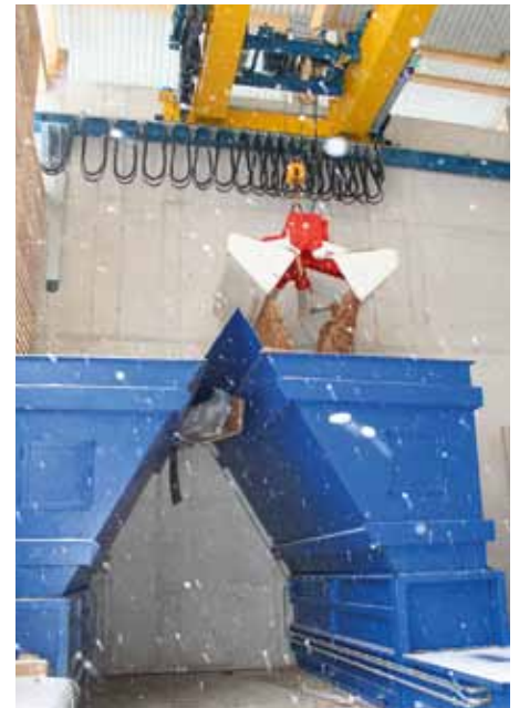
Die vollautomatische Krananlage lagert das Hackgut ein
