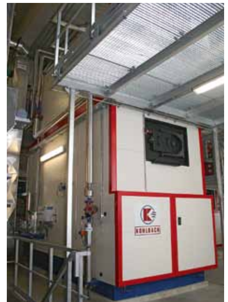
Der 2500 kW-Kessel wird vorerst im Winter und in der Übergangszeit befeuert
