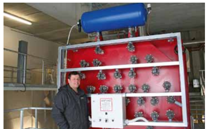
Die automatische Kesselreinigung mittels eingeblassener Druckluft zeigt Geschäftsführer Wolfgang Waltl
