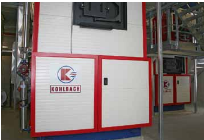
Die zwei Biomassekessel von Kohlbach haben eine Leistung von 2500 kW (li.) und 500 kW (re.)
