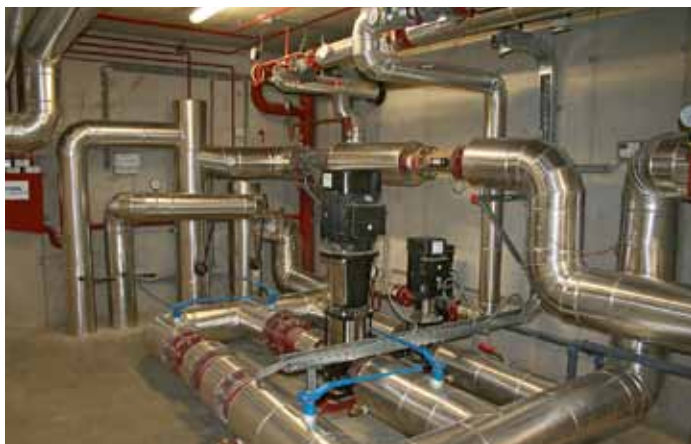
Mit dem Leitungsnetz aus Stahl wird in der Endausbau-Stufe sogar die Nachbargemeinde Ehrenhausen mit Wärme beliefert
