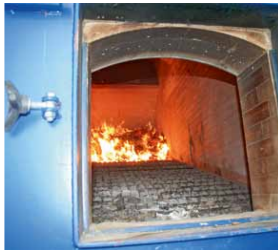
Optimale Verbrennung: Die Verfeuerung erfolgt mit Hackgut aus der Region
